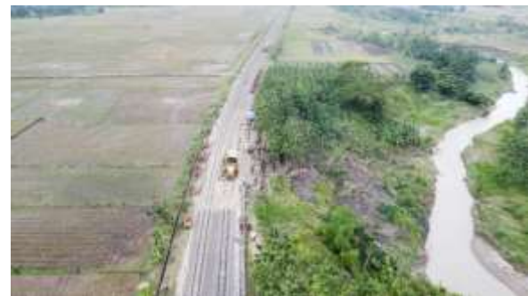
Gambar 3.2 Kondisi Km. 63+100 s.d 63+200 Daop 4 Semarang
